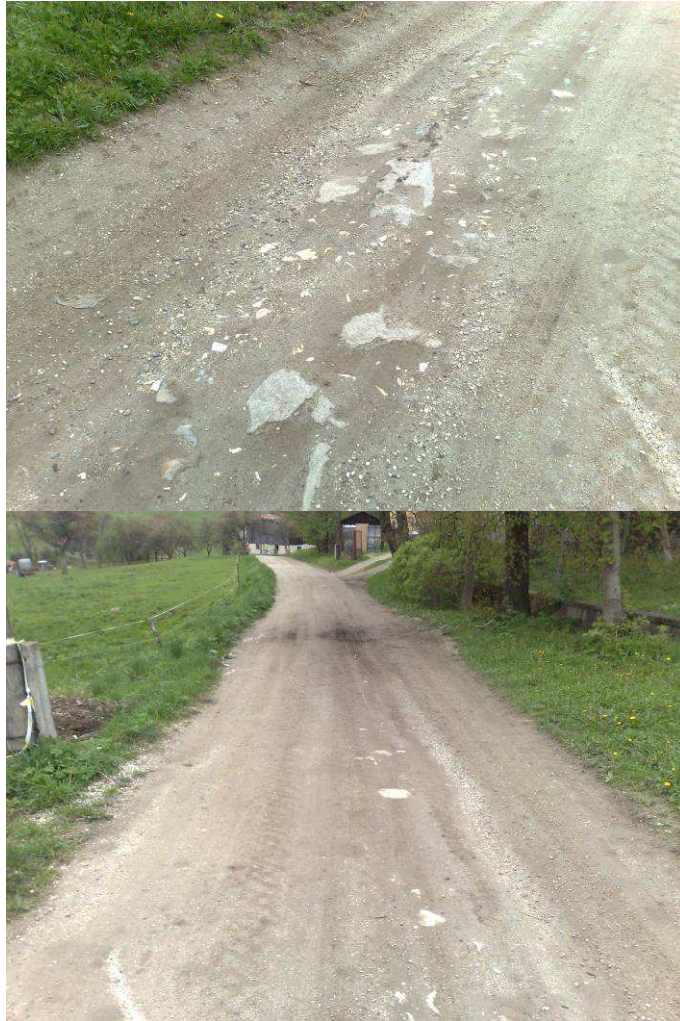
- 0+130 Km – stan nawierzchni i poboczy gruntowych, brak odwodnienia powierzchniowego, zjazd do posesji,
