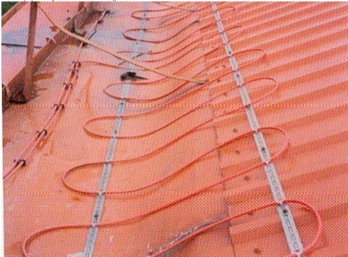
Elementy systemu przeciwoblodzeniowego
