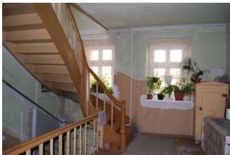
Klatka schodowa w poziomie I piętra – schody, balustrady do remontu, osłonić schody zabiegowe od spodu płytami gk ognioodpornymi.
