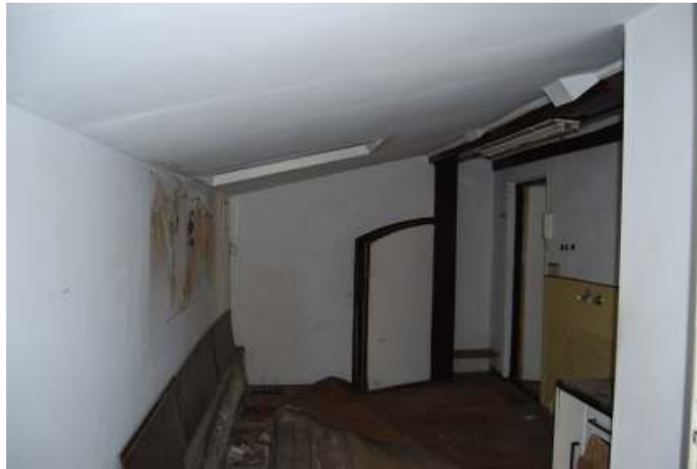
Przestrzeń strychowa w poziomie poddasza – widoczne u góry końcówki krokwi – projektowane uzupełnienie wg cz. konstrukcyjnej
