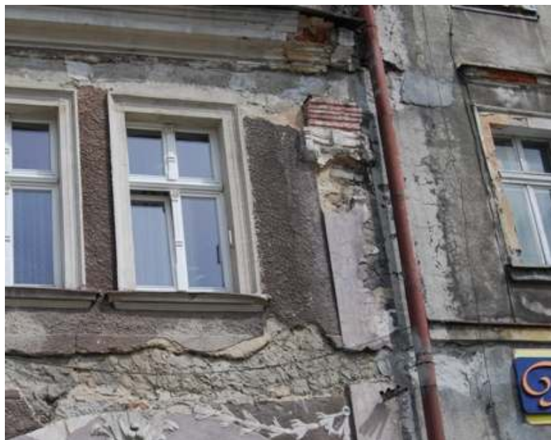
Uszkodzona głowica pilastra i gzyms przy rurze spustowej. Widoczna wymieniona stolarka okienna.
