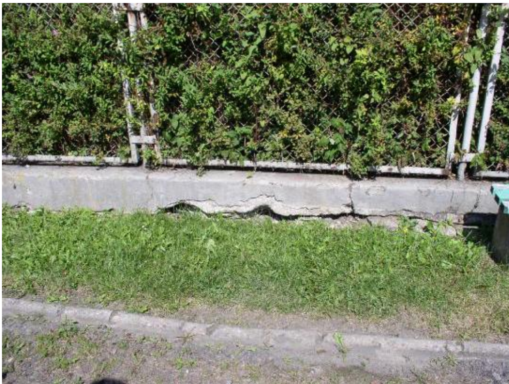
podmyte cokoliki ogrodzenia
