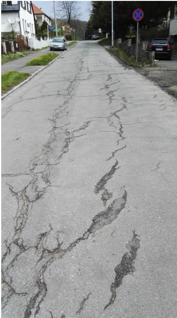
Fotografia: spękana nawierzchnia ulicy Wolności
