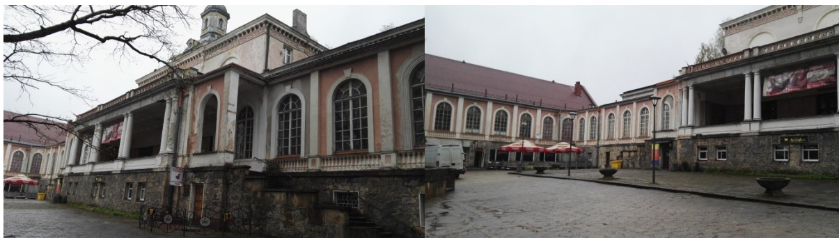
Fotografia: dom zdrojowy przy ul. Orlej, wymaga remontu i ewentualnej adaptacji pod inne funkcje
