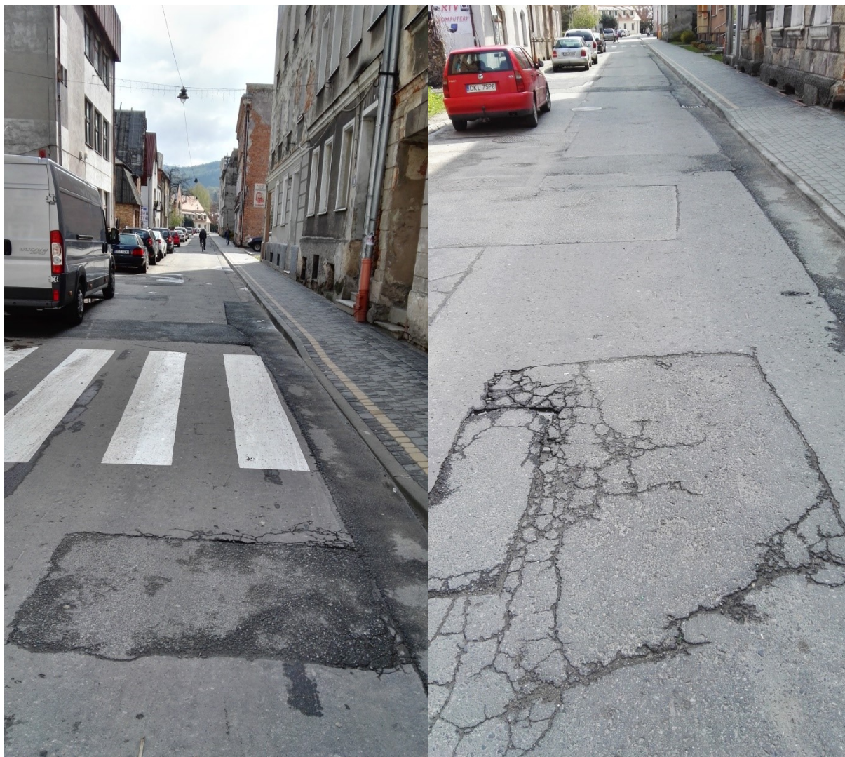
Fotografie: ul. Zdrojowa wymagająca pilnego remontu
