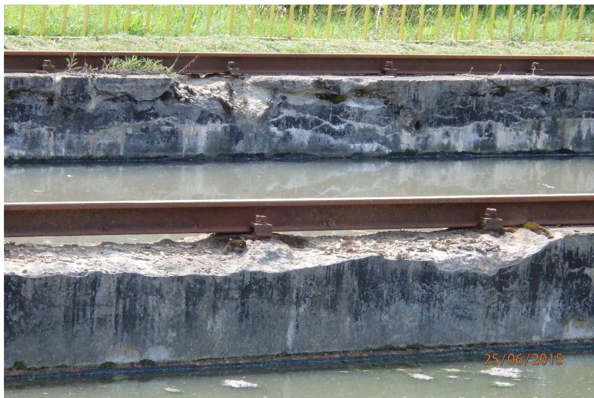
Zdj. Nr 2 uszkodzenie korony muru podłużnego
