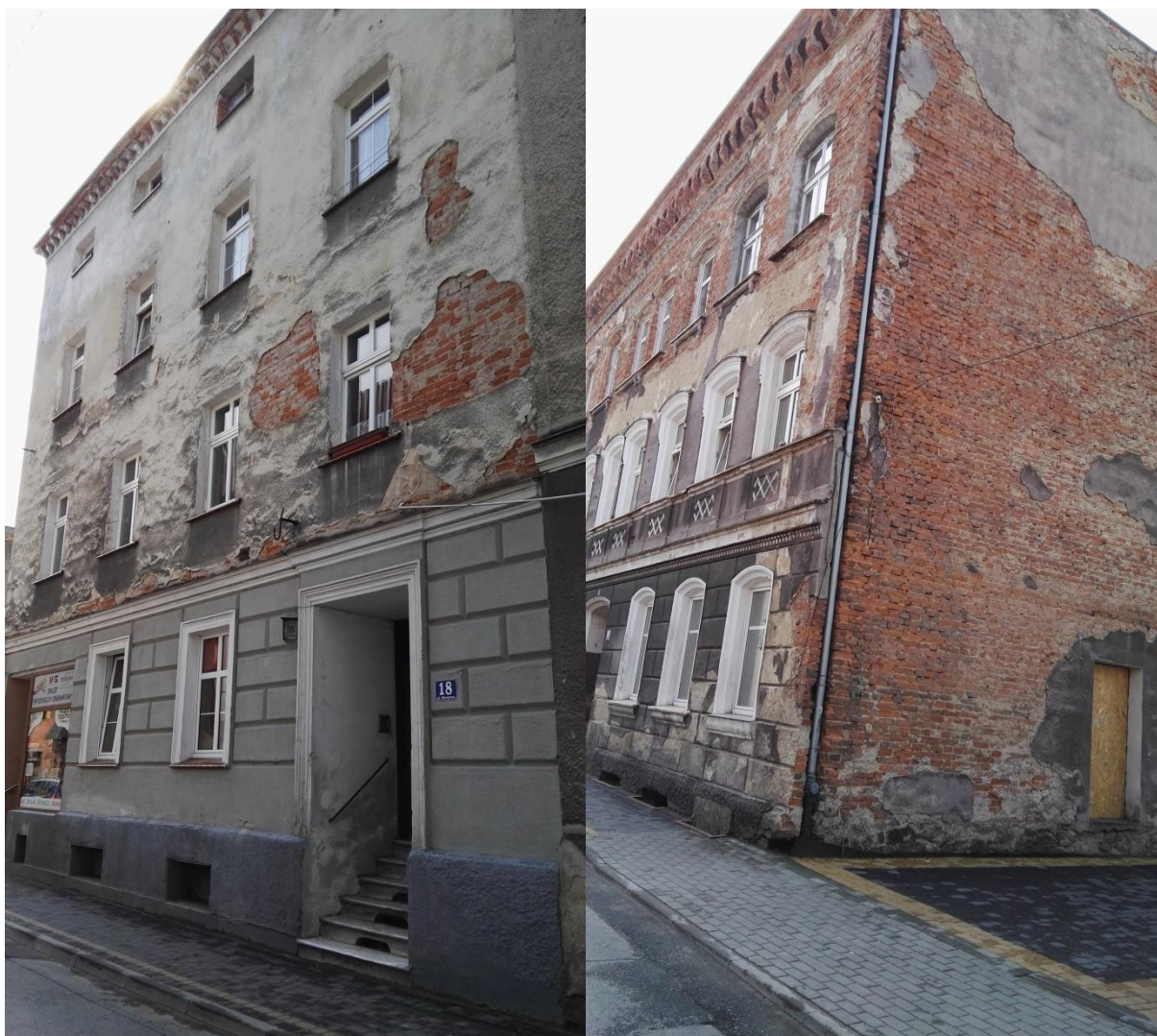
Fotografie: Przykłady kamienic mieszkalnych w złym stanie technicznym przy Rynku oraz ul. Zdrojowej
