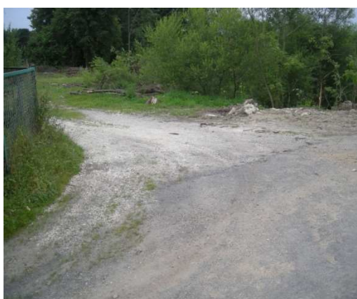
km 1+65,00 zjazd pełna konstrukcja z oczyszczeniem przepustu rowu i wykonaniem poboczy rys. nr 4
