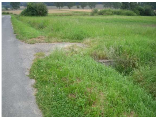
km 0+984,40 zjazd pełna konstrukcja z oczyszczeniem przepustu rowu i wykonaniem poboczy rys. nr 4
