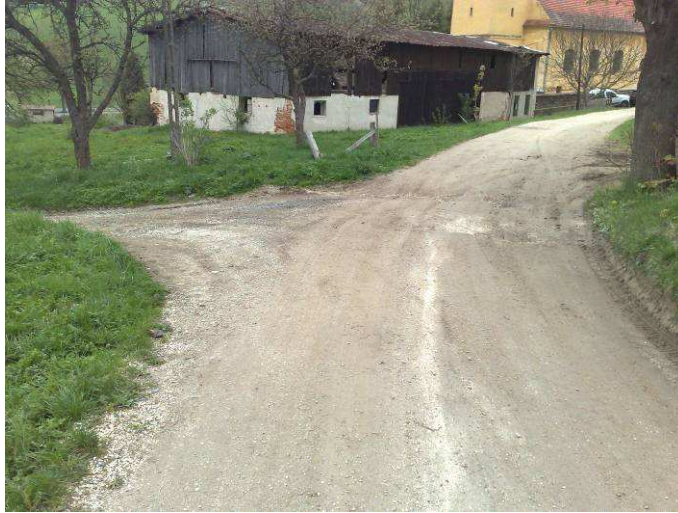
- 0+200 Km – stan nawierzchni i poboczy gruntowych, brak odwodnienia powierzchniowego, lokalne wyboje,
