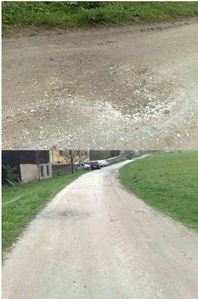
- 0+260 Km – stan nawierzchni i poboczy gruntowych, brak odwodnienia powierzchniowego, lokalne wyboje,
