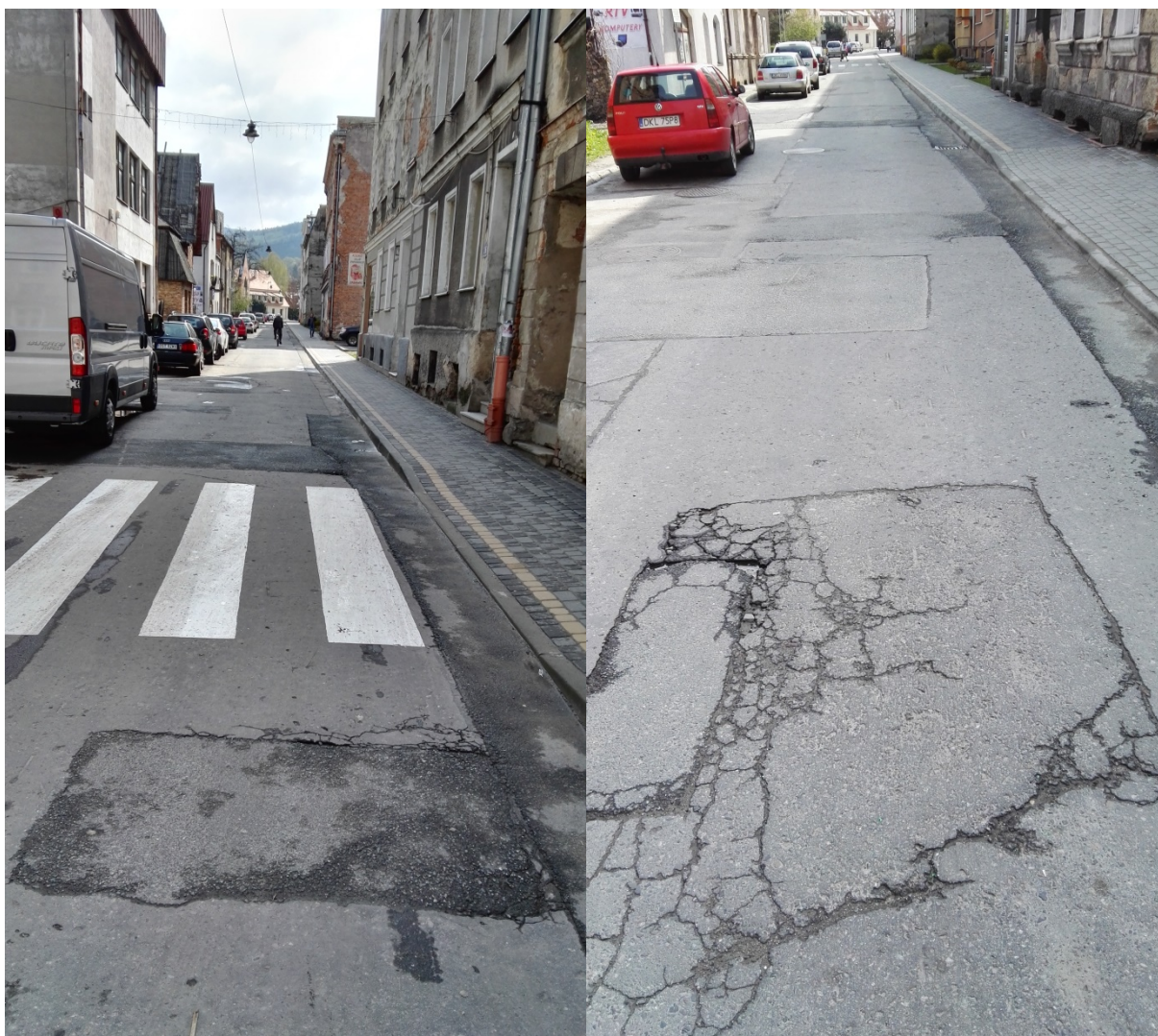
Fotografie: ul. Zdrojowa wymagająca pilnego remontu
