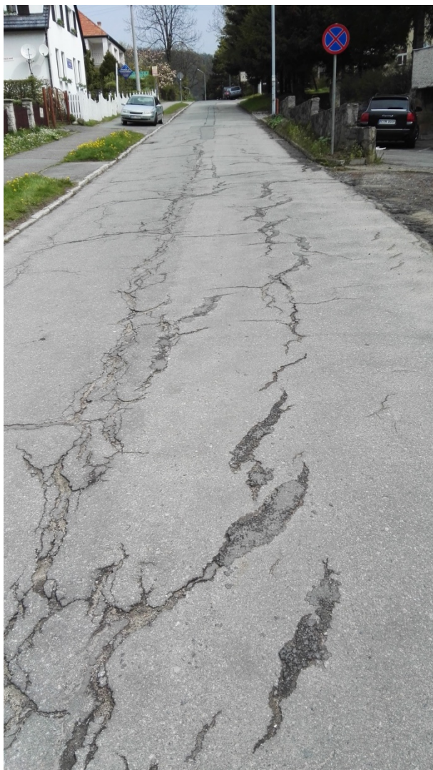
Fotografia: spękana nawierzchnia ulicy Wolności
