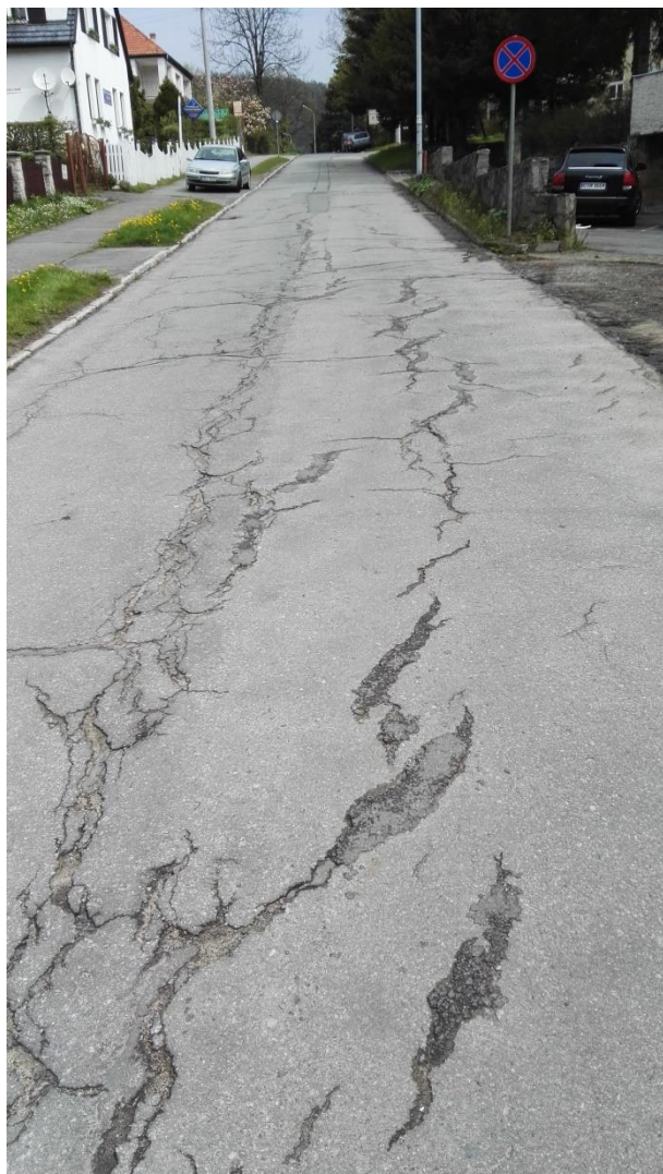
Fotografia: spękana nawierzchnia ulicy Wolności
