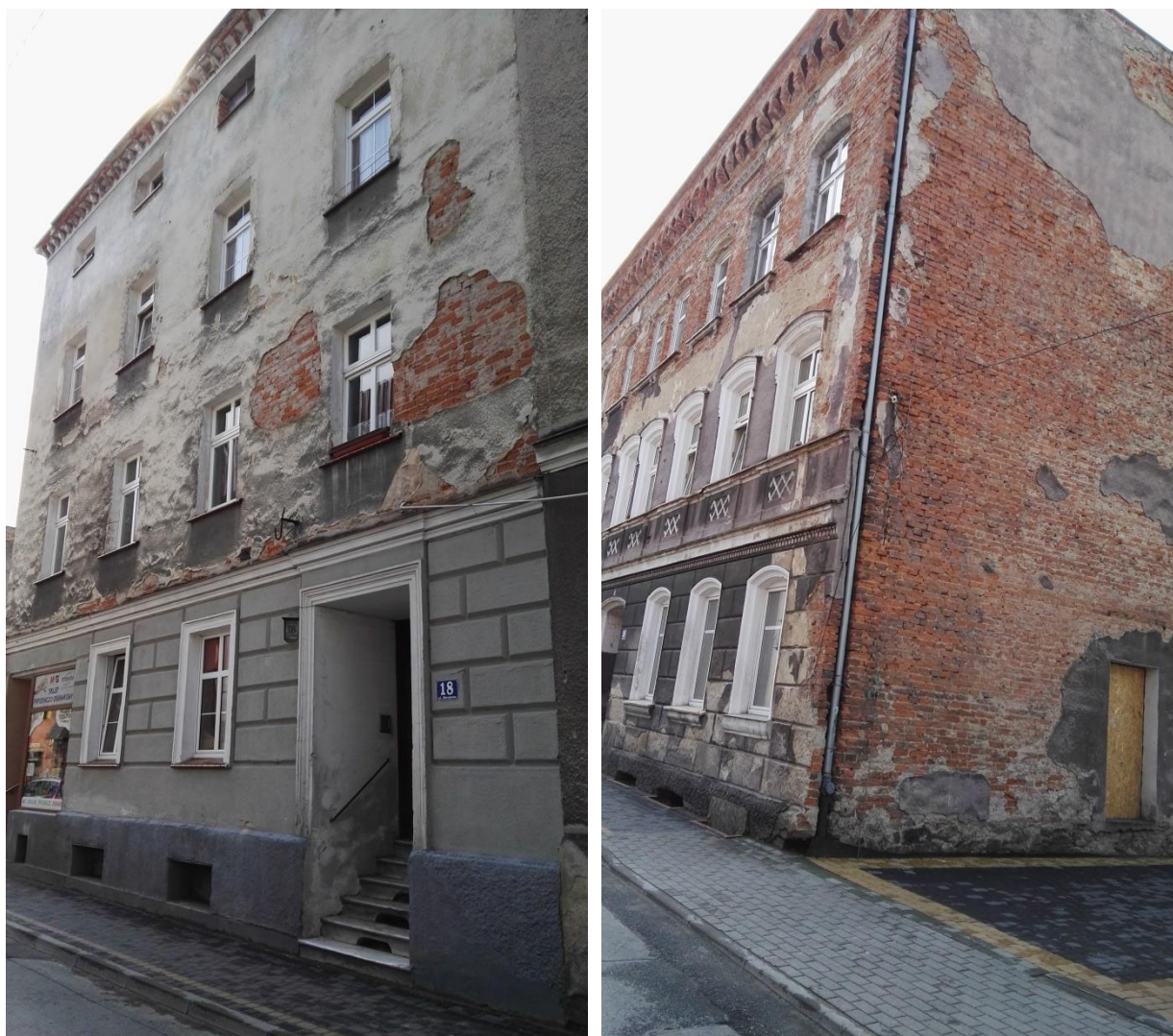
Fotografie: Przykłady kamienic mieszkalnych w złym stanie technicznym przy Rynku oraz ul. Zdrojowej
