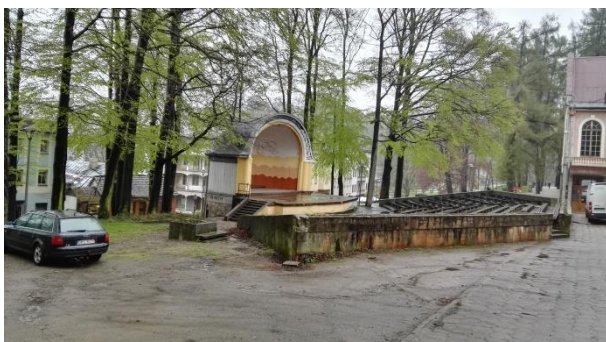
Fotografia: Przestrzeń publiczna i muszla koncertowa przy ul. Orlej i Cienistej, wymaga modernizacji i remontu
