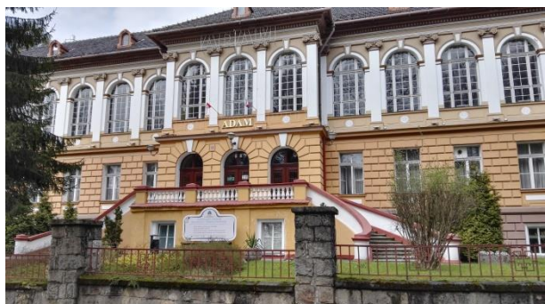
Fotografia: Obiekt ZPL „Adam” przy ul. Wolności, wymaga termomodernizacji
