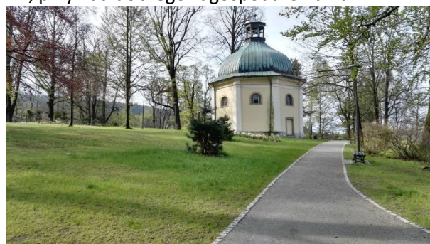
Fotografia: Park przy ul. Leśnej, przykład dobrego zagospodarowania, budynek kaplicy wymagający remontu
