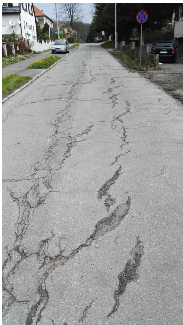
Fotografia: spękana nawierzchnia ulicy Wolności
