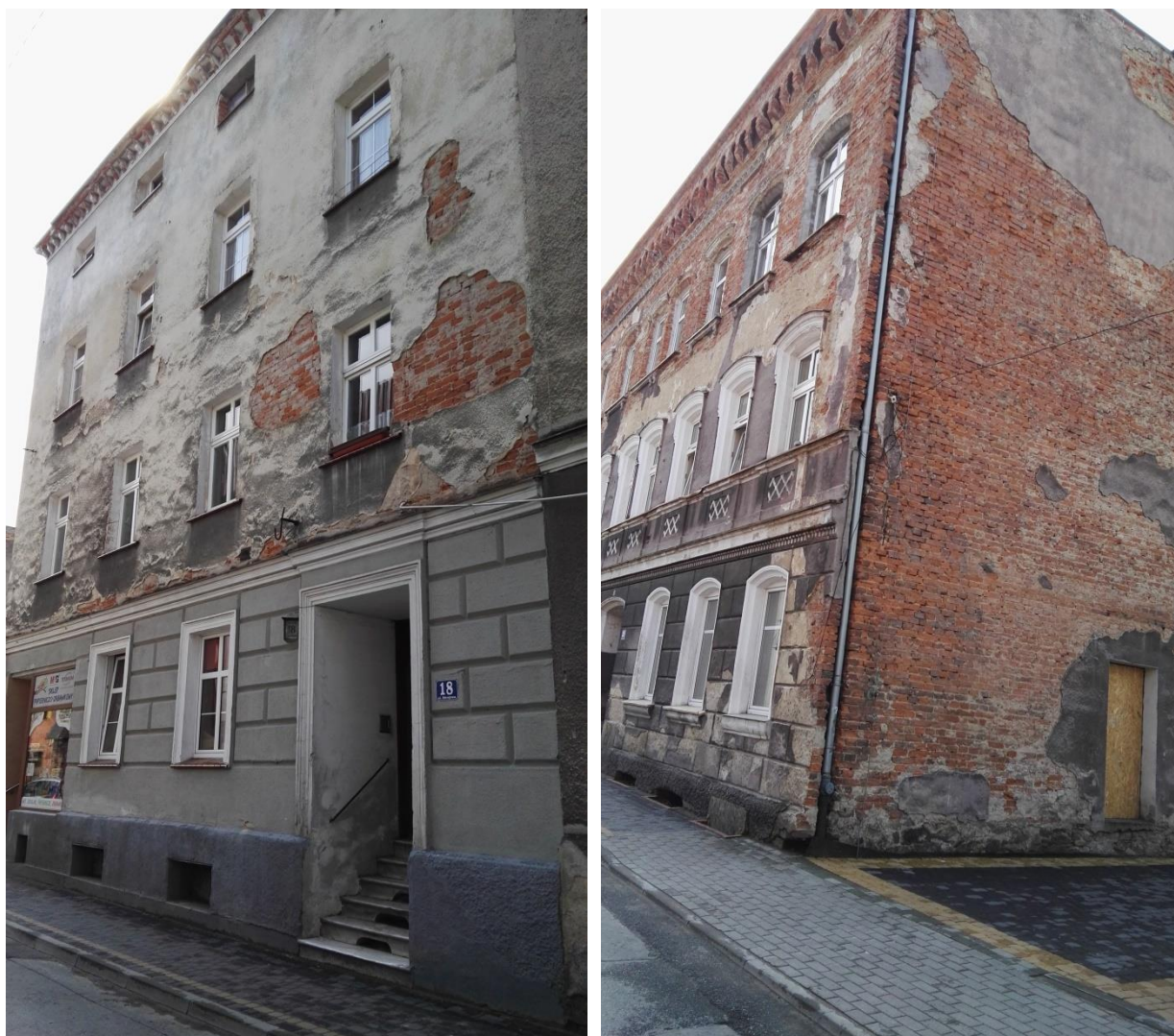
Fotografie: Przykłady kamienic mieszkalnych w złym stanie technicznym przy Rynku oraz ul. Zdrojowej
