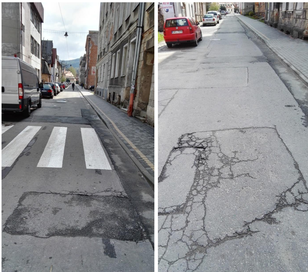
Fotografie: ul. Zdrojowa wymagająca pilnego remontu
